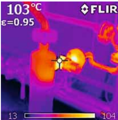
Praktische Energie-Effizient-Überwachung mit Wärmebild-Kamera
