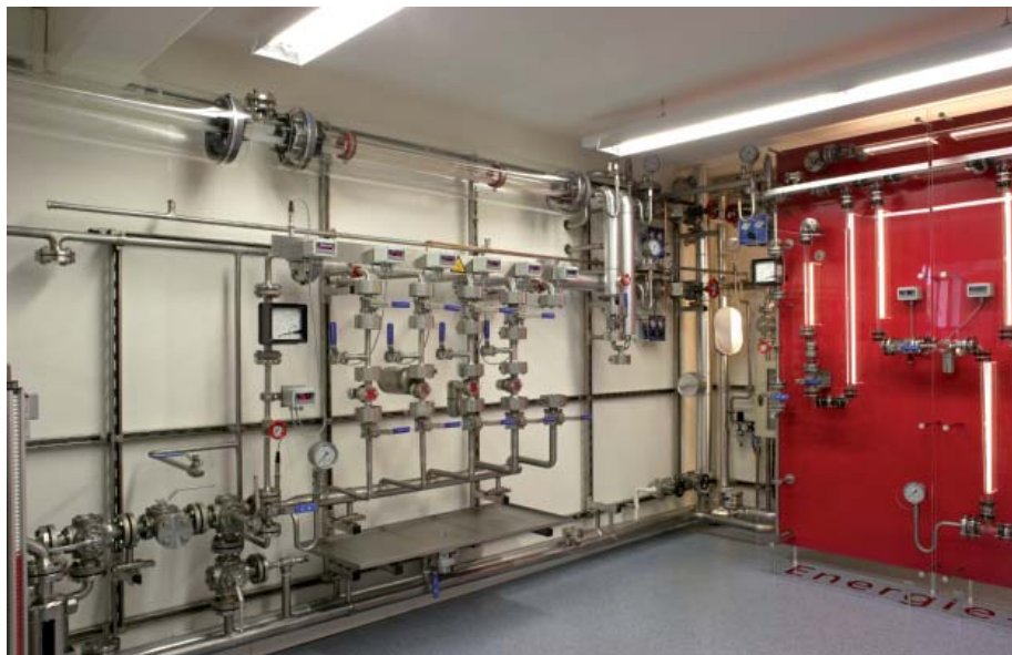
Abb. 1: Schulungscenter der Franz Gysi AG, Dampfanlage
