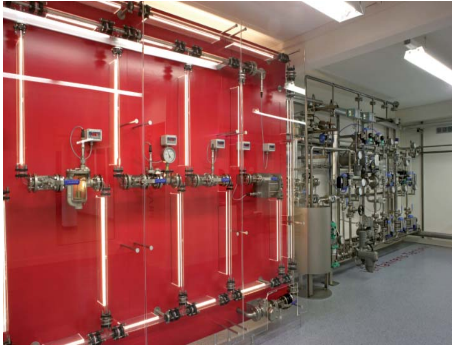
Abb. 2: Schulungszentrum der Franz Gysi AG, Kondensatabscheider
