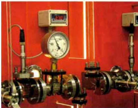
▲ Temperaturlaufnehmer TE23 im Schulungszentrum
