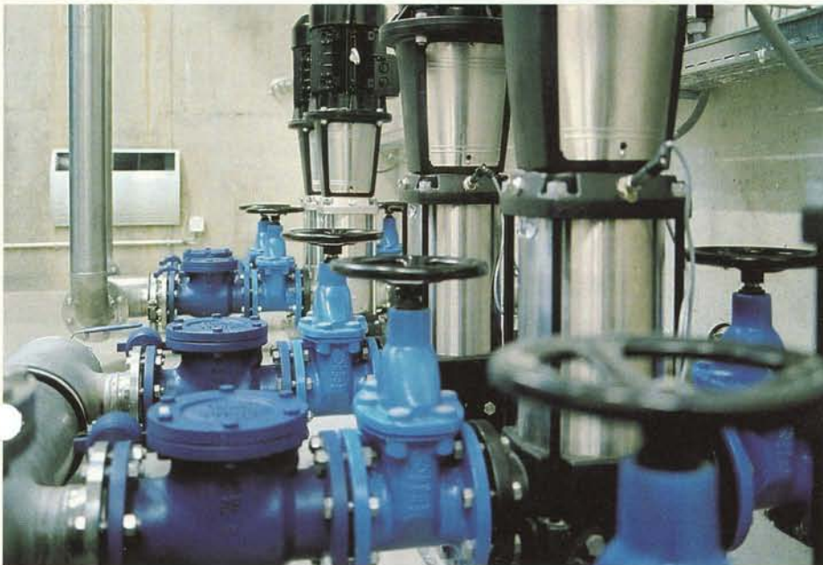
Abb. 4: Absperr-Schieber und Rückschlag-Klappen der Franz Gysi AG in einer Pumpstation. In dieser Anlage wird Enteiser-Abwasser gesammelt und rezykliert.
